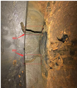
键槽磨损严重
